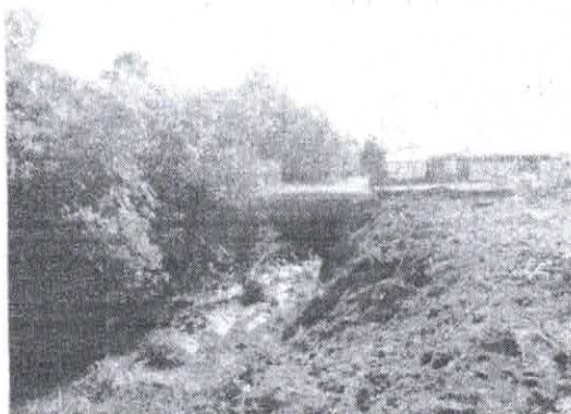
4A - Erosão instalada a poucos metros da sede da associação, ano 2019
