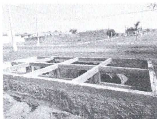
4D - Início da captação superficial no cruzamento da Av. Santa Helena com a Rua Medianeira
